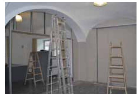
Im Juni wurde mit den Umbauarbeiten im Stiblersaal begonnen. Im Herbst wird das DARINGER Kunstmuseum Aspach eingerichtet.
